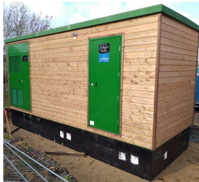
Illustration 15 : Exemple de poste de livraison – Centrale photovoltaïque de Saint-Jory de Chalais en Dordogne (Source : EREA Ingénierie )
